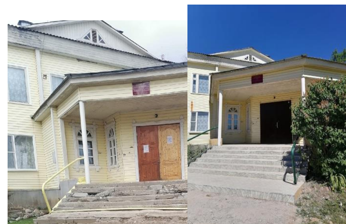
Капитальный ремонт ступеней и площадки входной группы здания Дома культуры с. Биряково Сокольского муниципального района
